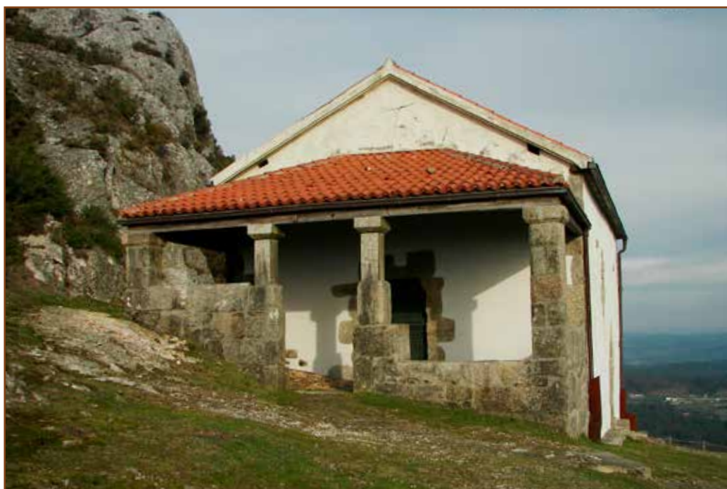
Estado actual de conservación da capela de San Sebastián.
