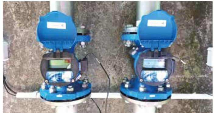
Dispositivos para a telexestión e mellora do abastecemento municipal de auga
